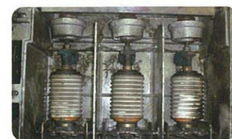
CB形の事故例 結露により短絡事故となった真空遮断器
