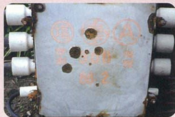
経年劣化により、錆が発生(施設後約10年経過)
