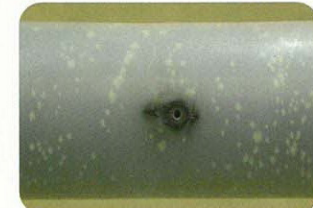
水トリーで絶縁破壊したケーブル
