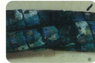
遮へい銅テープの腐食・破断
